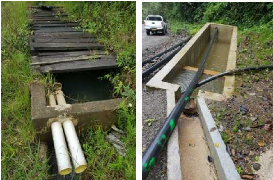
Figura 8. A. Drenajes controlados de aguas superficiales. B. Captación de aguas superficiales
