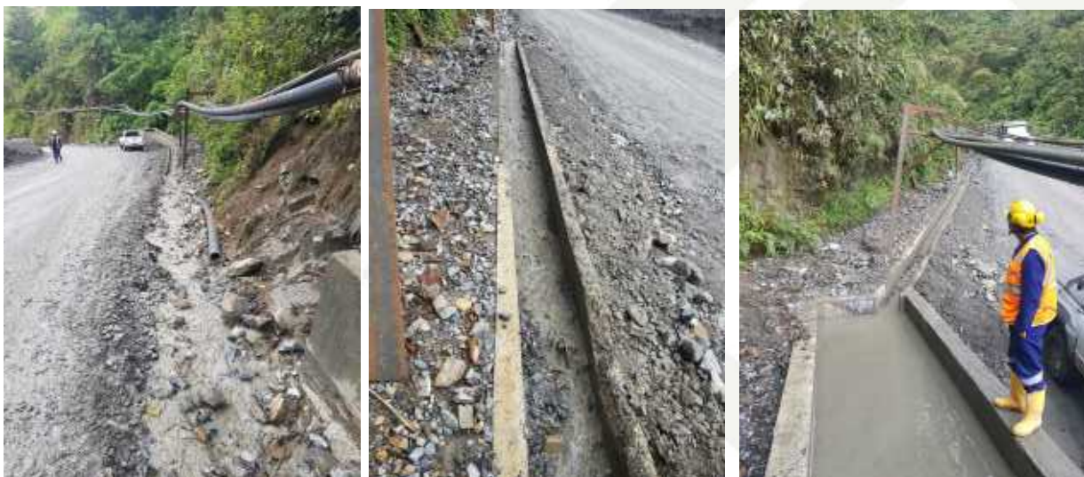
Figura 5. A. Sistemas de drenajes. B. Contaminación de material de mena de aguas superficiales
