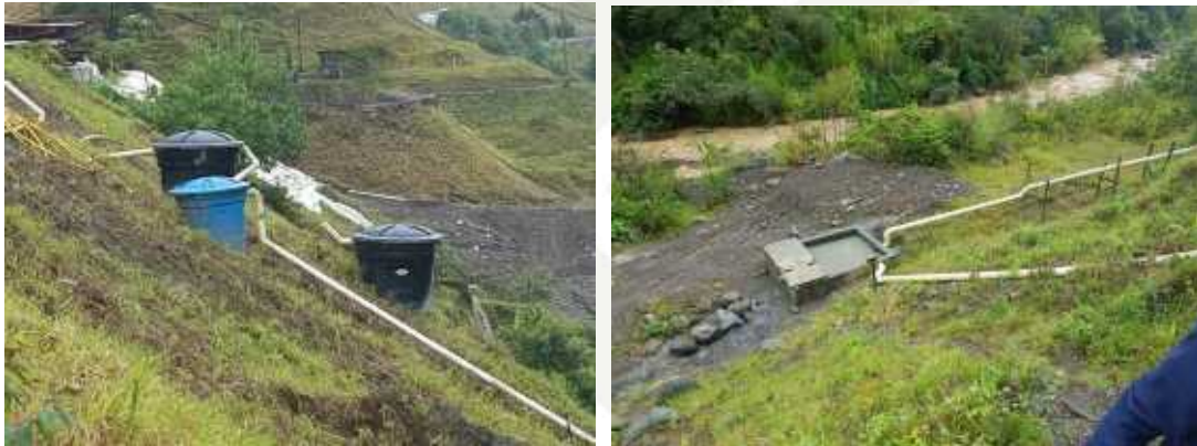
Figura 6. A. Tratamientos de aguas residuales domesticas. B. Aguas residuales
